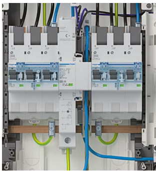
Abbildung 5: Überspannungsschutz mit Sammelschienenbox (Spannungsversorgung ungezählt) und Einspeiseadapter und zwei SLS in einem NAR
