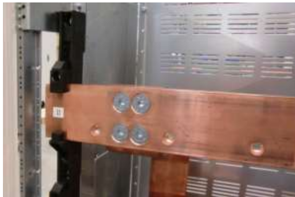
Einspeisung 185 mm SaS System
