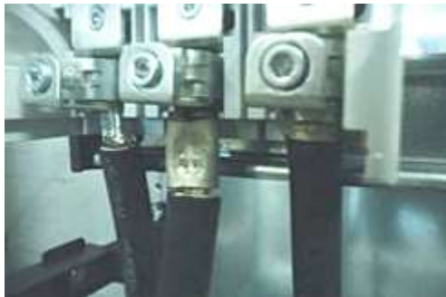
Kabelanschluss mit unzureichender Isolierung der Leiterenden
