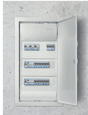
Abb. 3: FI-Schutzschalter mit sechs 1-poligen LS-Schaltern
