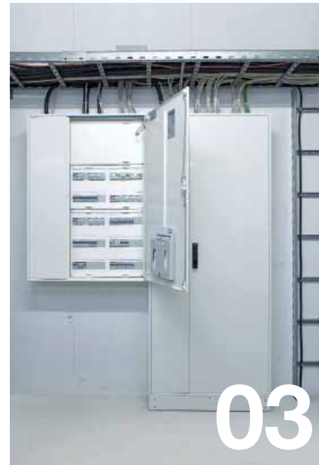
04 Hager univers Anreihstandschrnk Energieverteilung mit NH-Sicherungslastschaltleisten in Größe 1-3 und integrierten Wandlern zur Energiemessung
