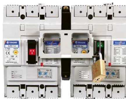
Installierte Schieberverriegelung mit Vorhängeschloss
