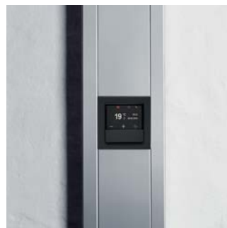
Steilvorlage: senkrecht montierter Edelstahlkanal mit KNX-Temperaturregler
