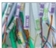
Repérage sur gaine
